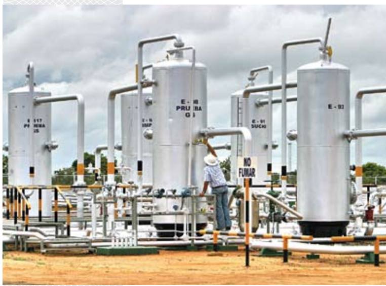
▼ Нефтеподготовительная станция в Венесуэле
