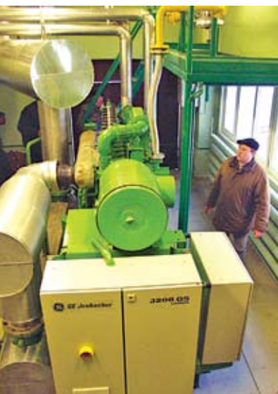
Когенерационная установка, вырабатывающая одновременно электрическую и тепловую энергию. Лидское районное сельскохозяйственное унитарное предприятие «Можейково»
