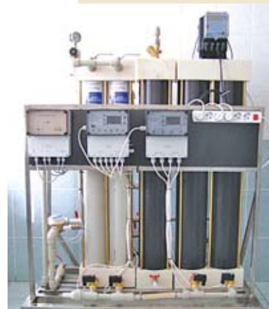
Многофункциональная установка очистки воды
